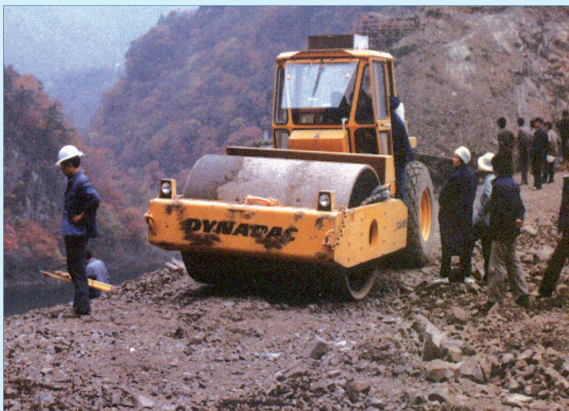
YS-1 型压实计在辽宁省 关门山水电站面板堆石坝 施工中应用
