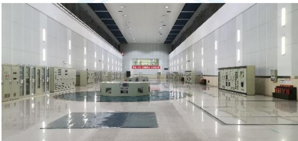
图4 惠州抽水蓄能电站厂房
