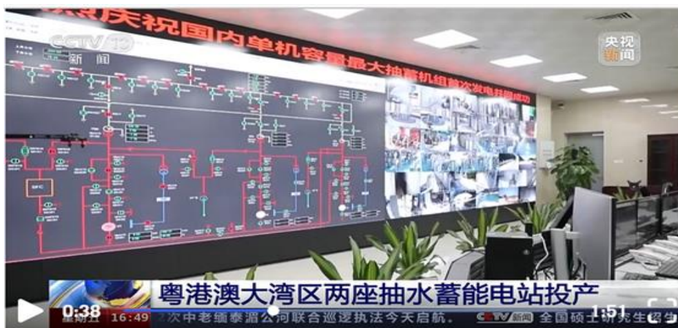
图3 央视报道中的阳江抽水蓄能电站自动控制系统
