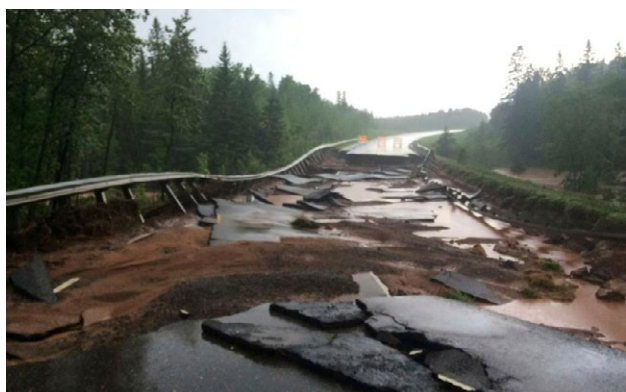
2018年6月17日,位于明尼苏达州德卢斯西南部的23号高速公路受损严重
