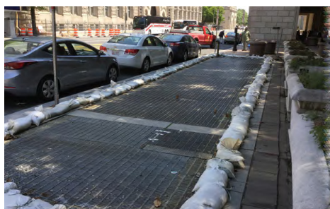
图 6. 图片为华盛顿地铁地下通风口阻挡暴雨的沙袋。
