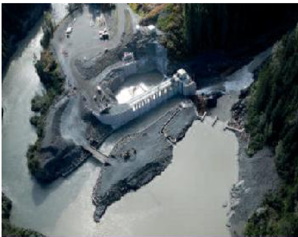
图 包含实地监测传感器、泥沙疏浚设施和除沙设施的进水设施
