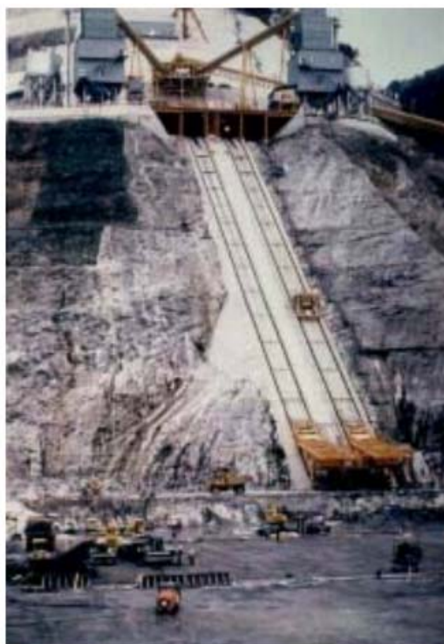
图 3-3 斜坡运输系统
